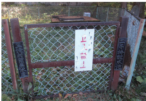
写真3. 二子持地区の配水池 (2019年11月20日撮影)。 Photo 3. Water supply reservoir in Futagomochi district.
